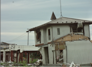
津波で破壊された住宅
