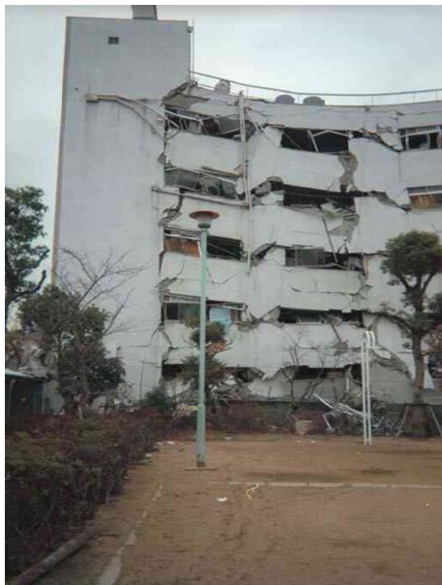
阪神淡路大震災 大きな被害を受けた集合住宅
